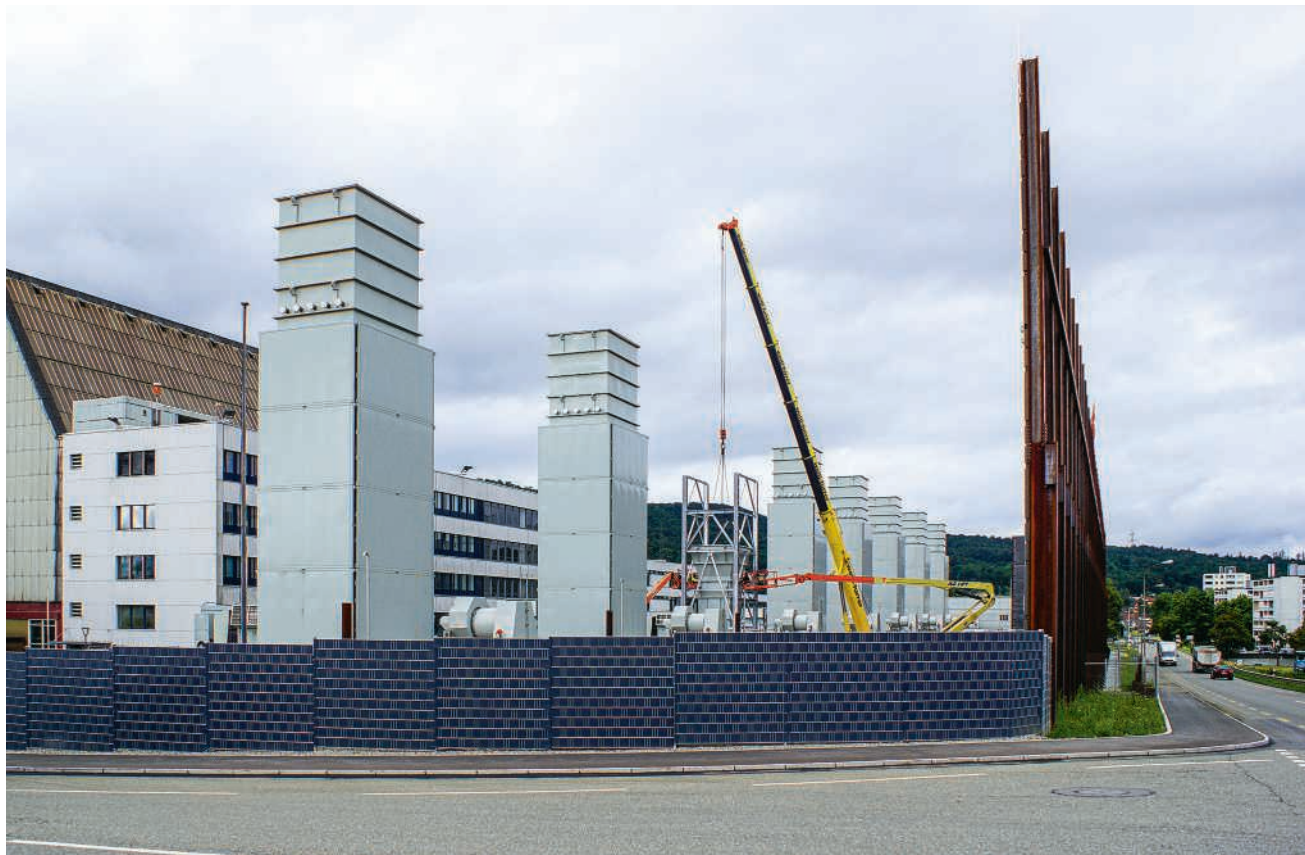
Sieben der acht mobilen Ölgasturbinen des Notkraftwerks in Birm wurden mittlerweile mit Schallschutzdämpfern nachgerüstet, sie dürften dadurch weniger Lärm verursachen als ursprünglich angenommen
