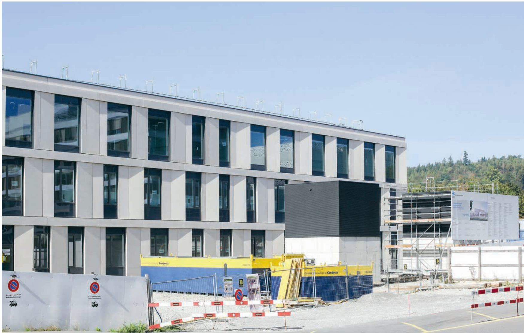
Der neue Gesundheitscampus wirkt von aussen schon beinahe fertig, auch wenn im Neubau noch kräftig gebaut wird
