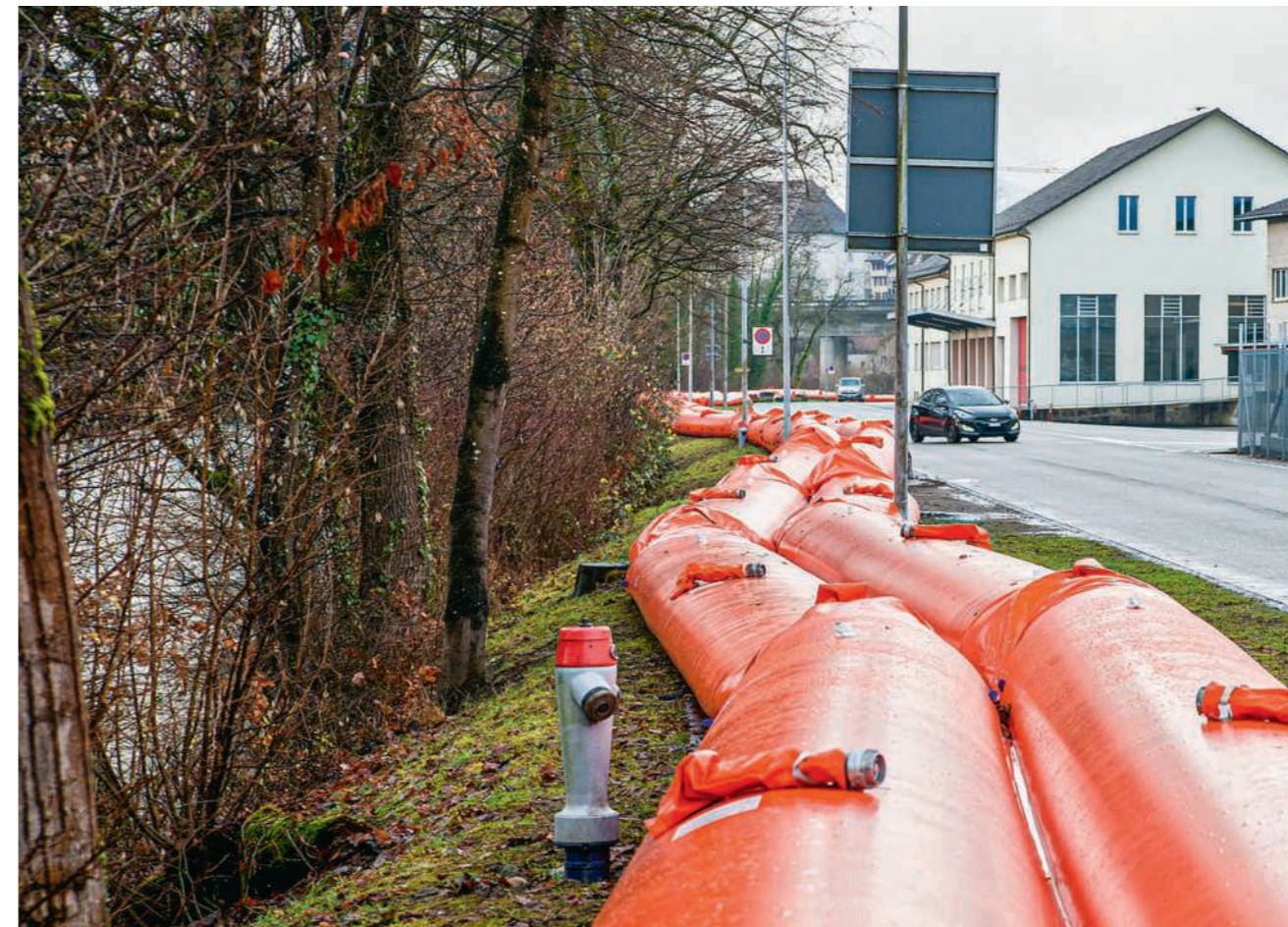
Orange Beaver-Schläuche schützen entlang der Ländistrasse in Brugg das Hinterland vor dem Hochwasser
