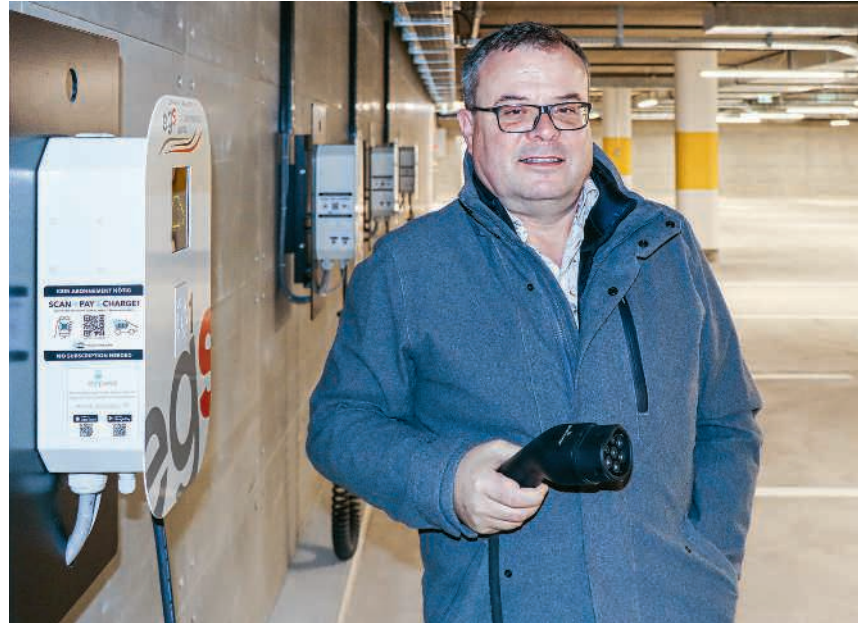
Gemeindeammann Adrian Hitz an einer Ladestation in der Tiefgarage der Sickinga-Hallen
