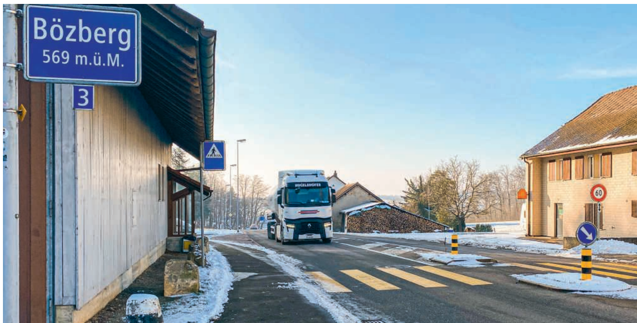
Die Bözbergstrasse ist weniger befahren als früher, aber der Strassenbelag ist in die Jahre gekommen und wird jetzt saniert, und der Veloverkehr erhält eine markierte Spur
