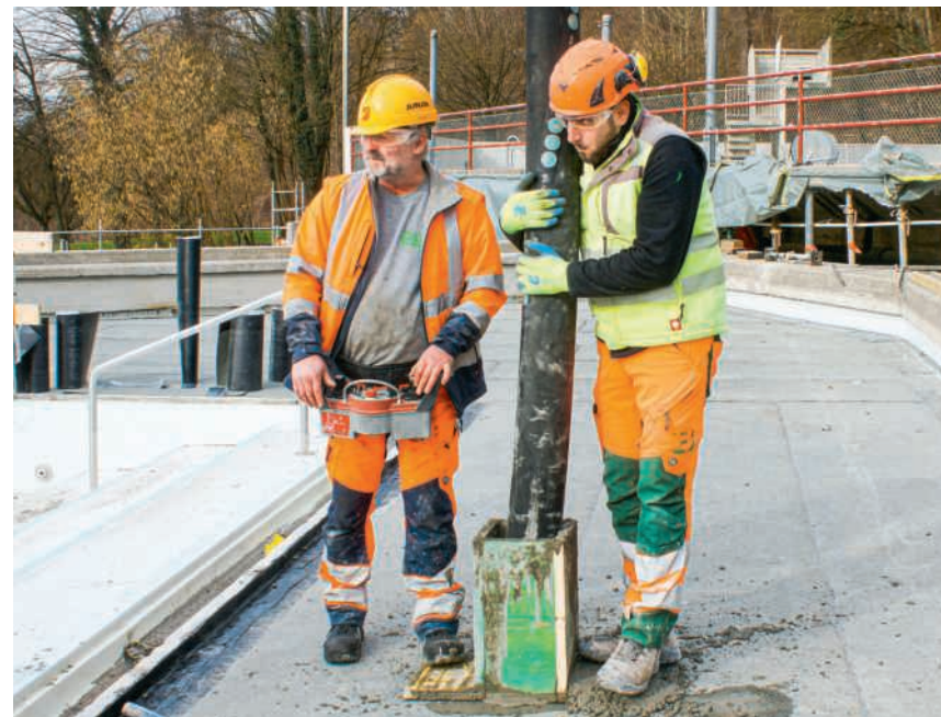
Mittels Betonpumpe wird der Beton von oben durch die Decke in die Schalung eingebracht
