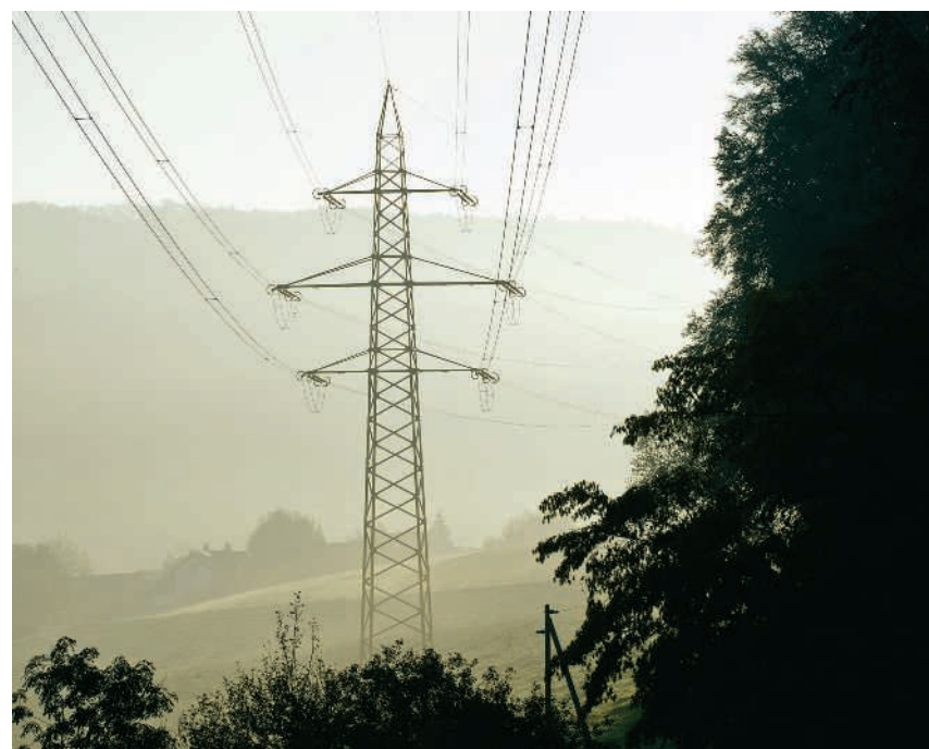
Die Zukunft des Elektrizitätswerks in Windisch ist geklärt
