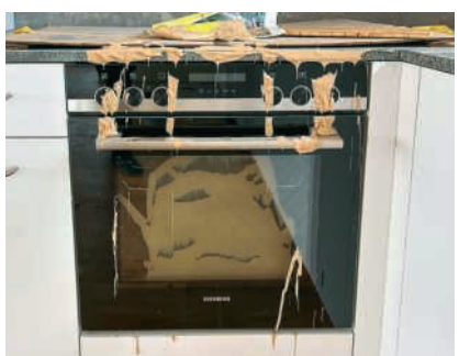
Neubau beschädigt BILD: ZVG
