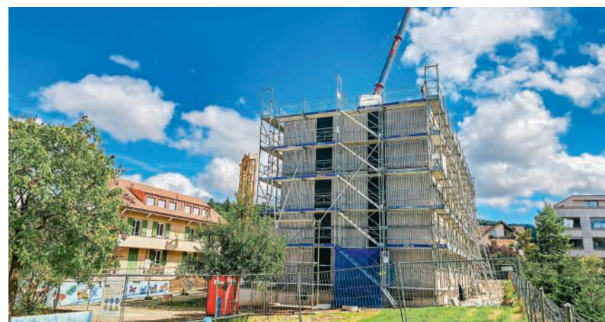
Die Sanierung der Schule Leematten endet vorerst mit dem Holzmodulbau Leematten IV
