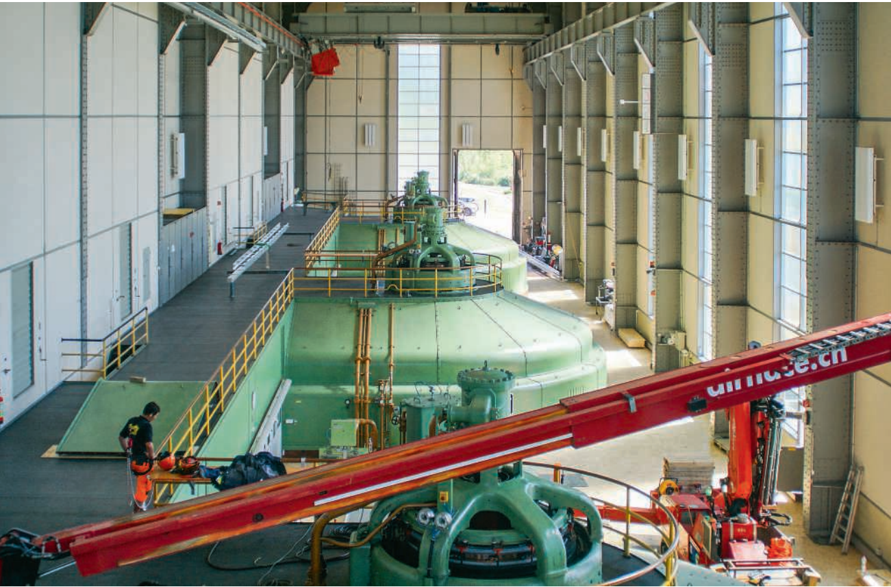
Der Blick in die Maschinenhalle offenbart die engen Platzverhältnisse
